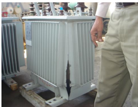
تصویر (۴): انفجار داخلی ترانسفورماتور در اثر برخورد صاعقه
