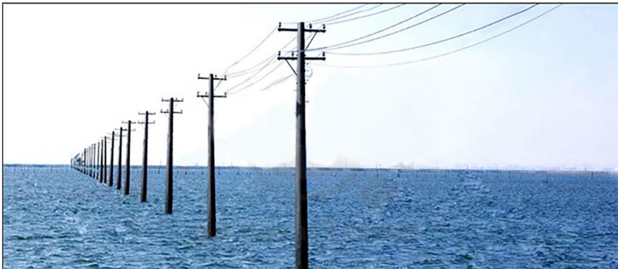
استفاده از پایه کامپوزیت برای انتقال برق در سواحل ، دریا و بستر رودخانه ها
